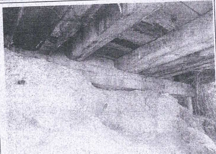
LOCAL PONTE SOBRE O IGARAPÉ DO JUÇARAL 1.9 FONTE: FRANCISCO FONTENELE- FOTO PARTE INTERNA DA PONTE ALAS (CAIXA)
